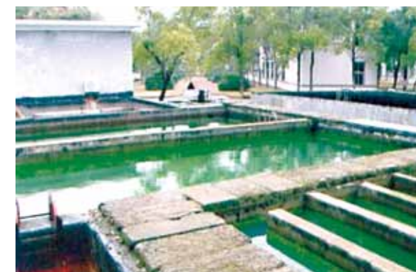
湖南云箭公司污染废水处理设备和废水处理池
