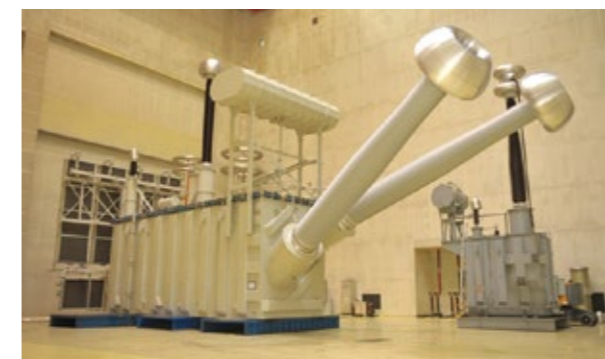
上海庙 - 临沂工程换流变压器
