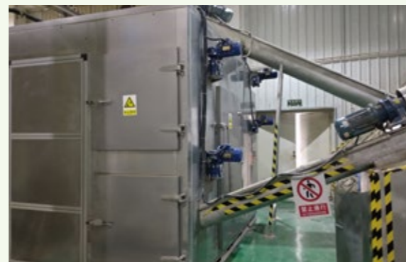
长安汽车污泥干化装置
